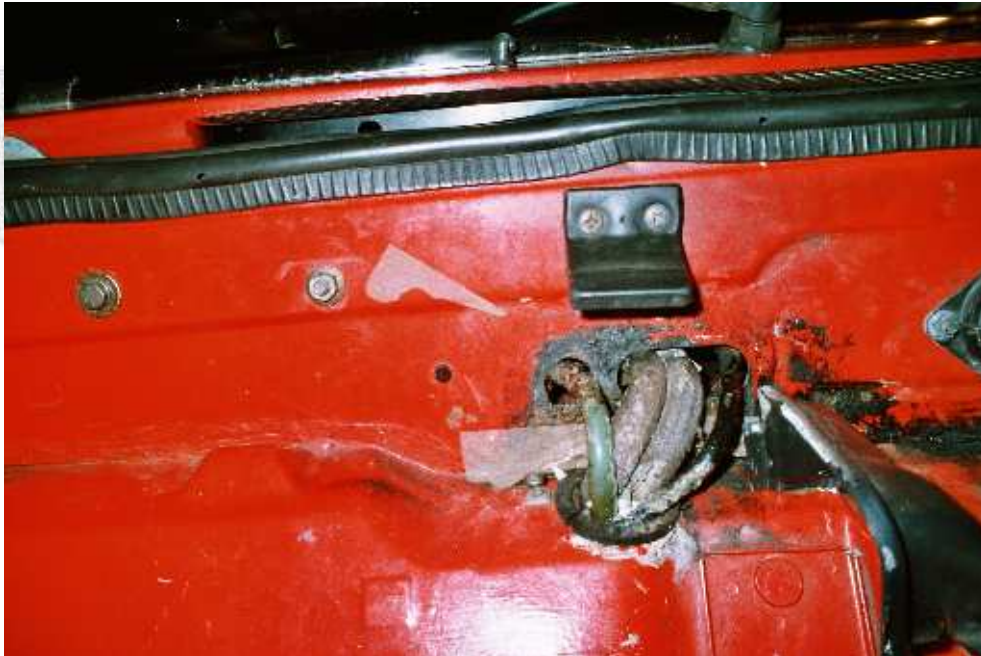
Wasserkasten von Kofferraum aus gesehen mit Durchführung der Kupplungs- und Bremsschläuche
